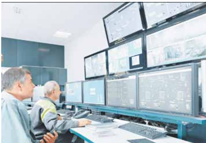
Расширенная система автоматизации 800xA от компании АББ контролирует весь завод и каждую единицу оборудования всего рудника.
