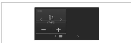
Kuva 20: Paneelinäkymä ja käyttöelementti
