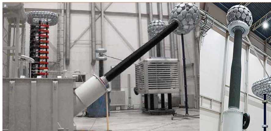
5 Avant exploitation commerciale, les équipements d'une liaison CCHT 800 kV doivent se soumettre à une batterie de tests : a transformateur, b traversée du transformateur et celle du bâtiment des valves (p. 22), testée à Ludvika (Suède).
