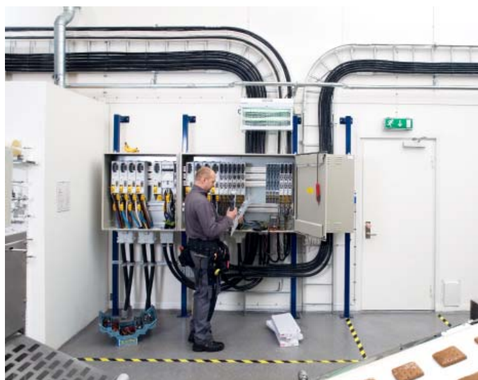
Fördelningscentral i lackad kapsling monterad på vägg i bageri, Göteborg.
