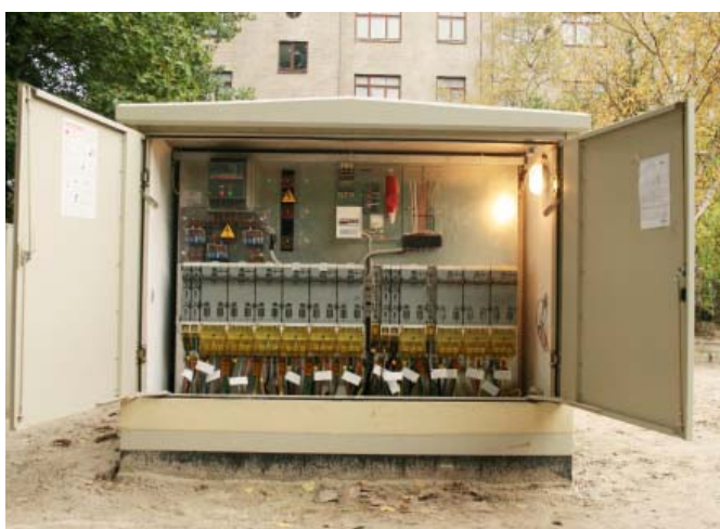
Säkringslastfrånskiljare i nätstation, Riga, Lettland.
