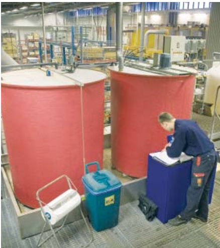
Rensningsverk för utgående avloppsvatten från ytbehandling.
