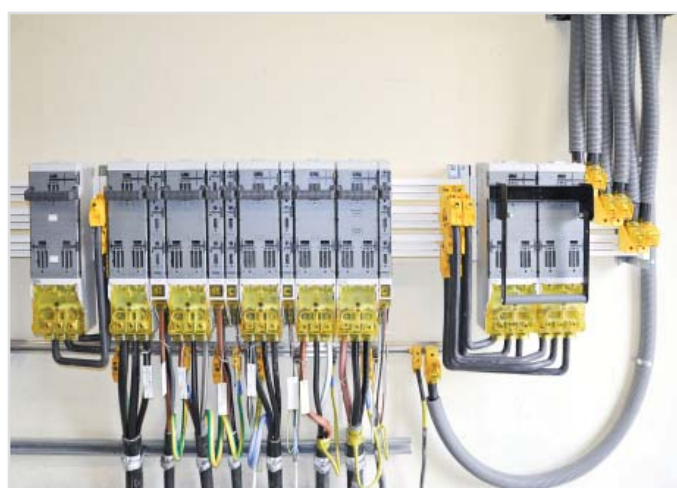
Exempel på användning av Kabelon produkter direkt på vägg i lågspänningsställverk, Sverige.
