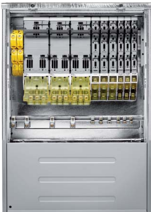
Kabelskåp med Kabeldon IP-system.
