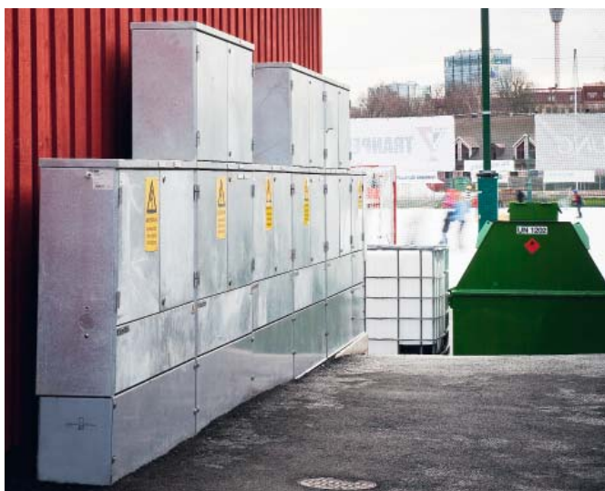
Fördelningscentral vid Hedens bandybana, Göteborg.
