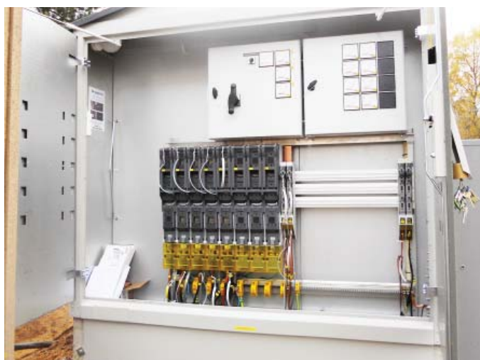
Kabelon säkringslastfrånskiljare i lågspänningsställverk, Sverige.
