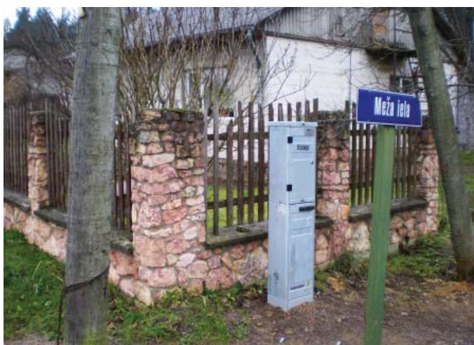
Kabelskåp med ovandel CDCM 420 använt som mätarskåp, Lettland.
