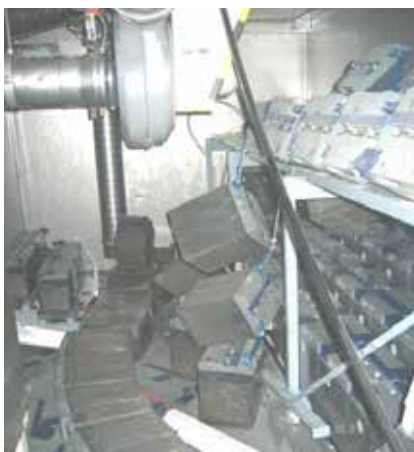
Ohne Be- und Entlüftung (Knallgasexplosion)
