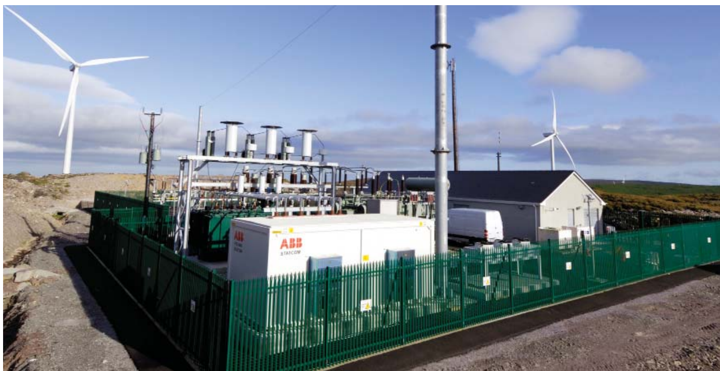
System VARPro STATCOM zainstalowany na terenie farmy wiatrowej w Wielkiej Brytanii zapewnił zgodność z warunkami przyłączenia do sieci
