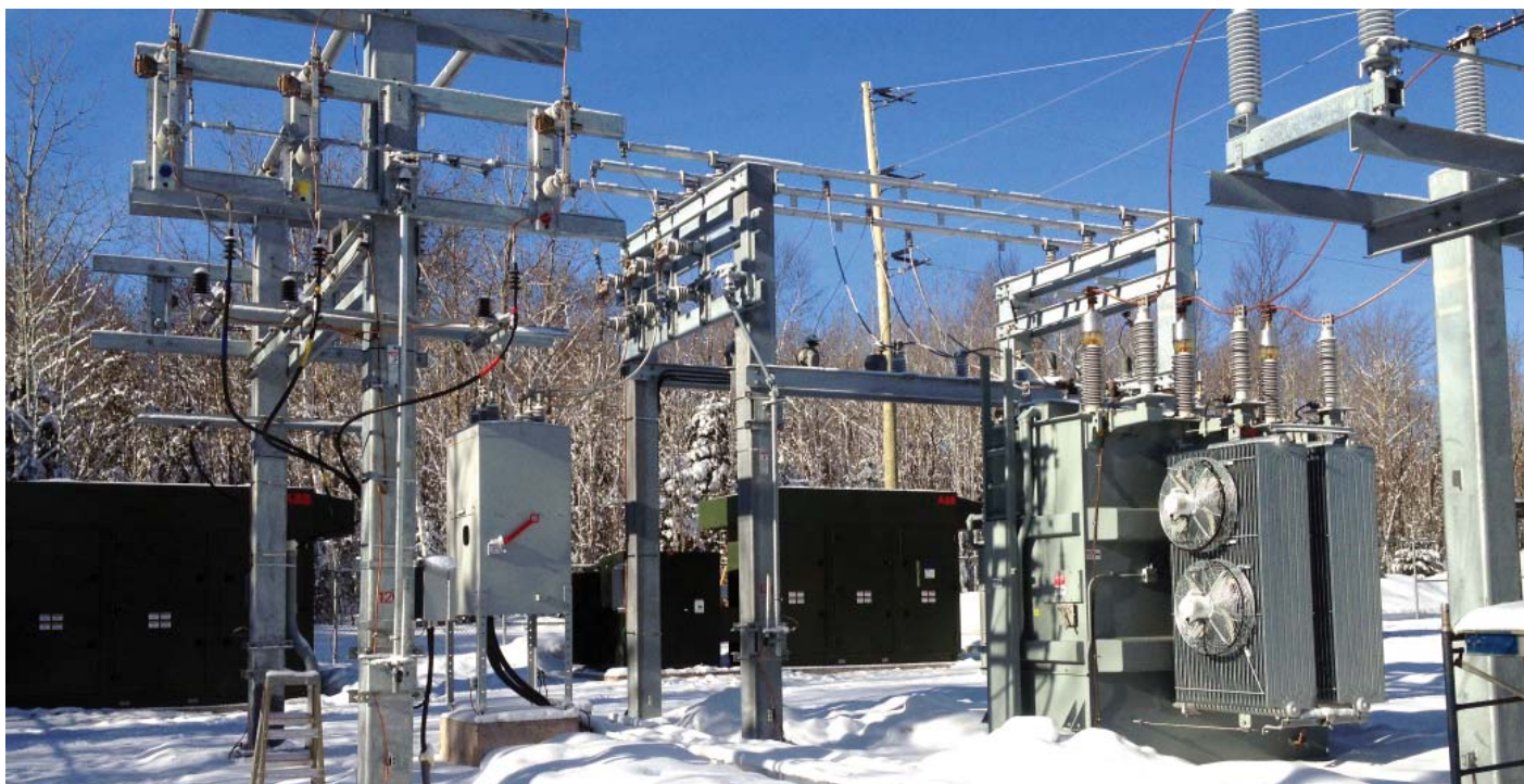
VArPro STATCOM zainstalowany na stacji elektroenergetycznej w kanadyjskiej prowincji Maritime umożliwił płynną integrację farmy wiatrowej
