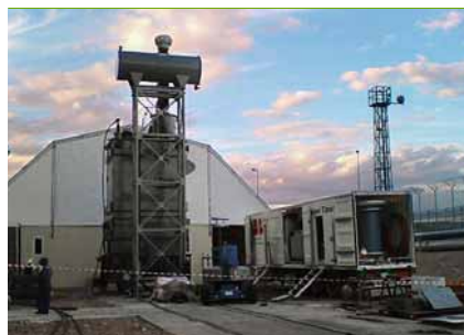
1b Poste d'essai d'un transformateur de centrale nucléaire
