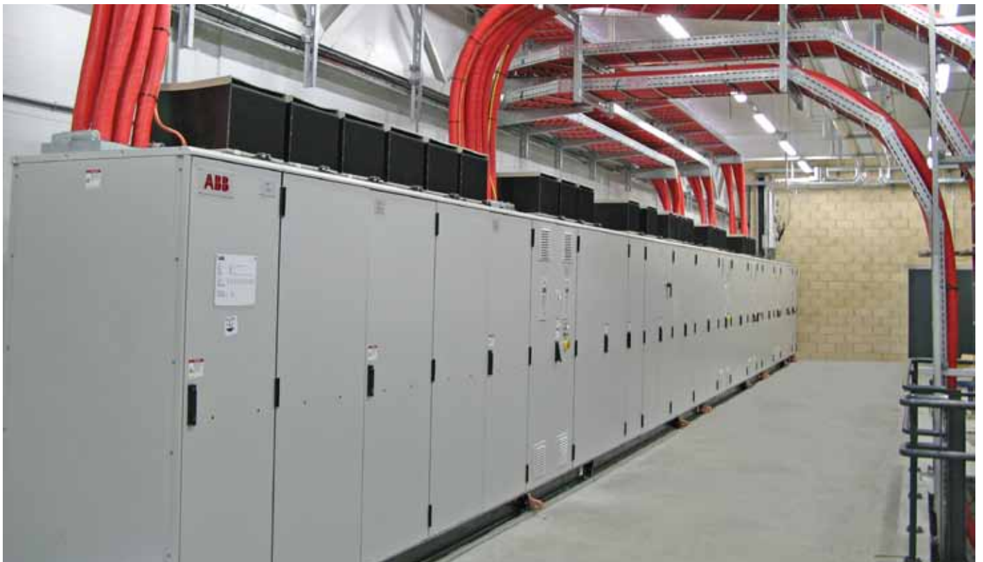
ACS 6000 Multidrive, con una potencia nominal total de 36 MVA, controlando los bancos de ensayos del CENER.
