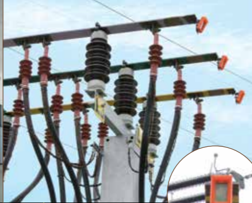
WSKAŹNIKI VISIVOLT NA INSTALACJI W BISKUPICACH
