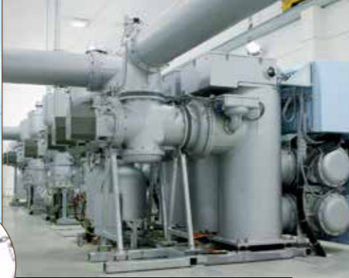
9-POŁOWA ROZDZIELNICA GIS 110 KV – WIDOK OD STRONY SZYN ZBIORCZYCH
