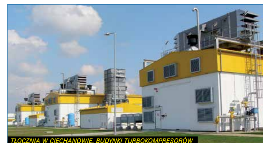
TŁOCZNIA W CIECHANOWIE, BUDYNKI TURBOKOMPRESORÓW
