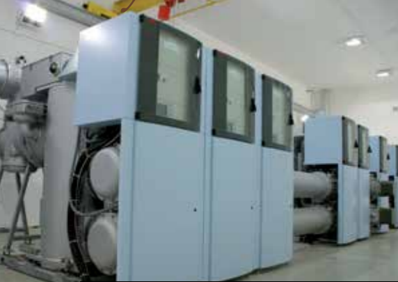
9-POŁOWA ROZDZIELNICA GIS 110 KV – WIDOK OD STRONY SZAF STEROWANIA LOKALNEGO
