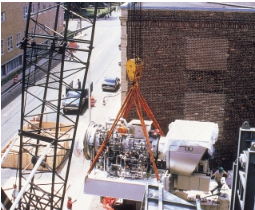
En gasturbin av typ GT10 lyfts in i en befintlig byggnad vid Massachusetts Institute of Technology (M.I.T.) i Boston, USA.
