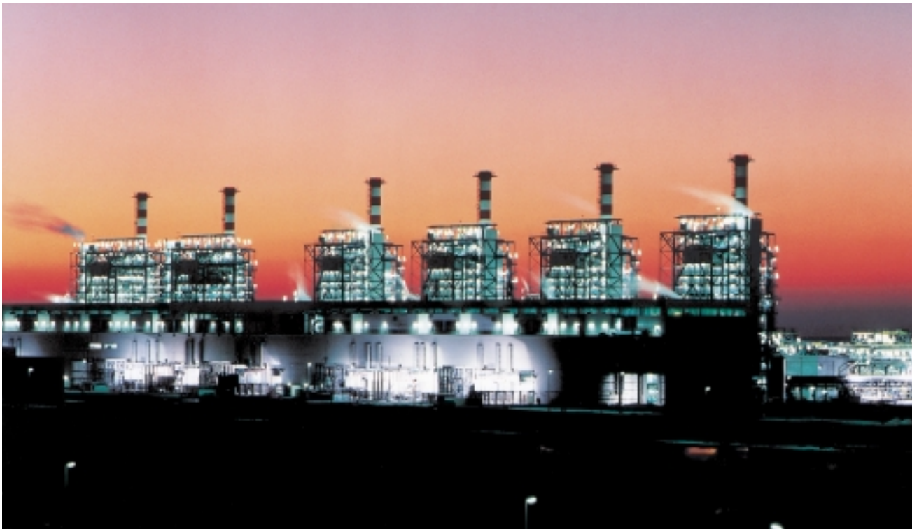
La centrale énergétique à vapeur Al Taweelah B en pleine exploitation commerciale
