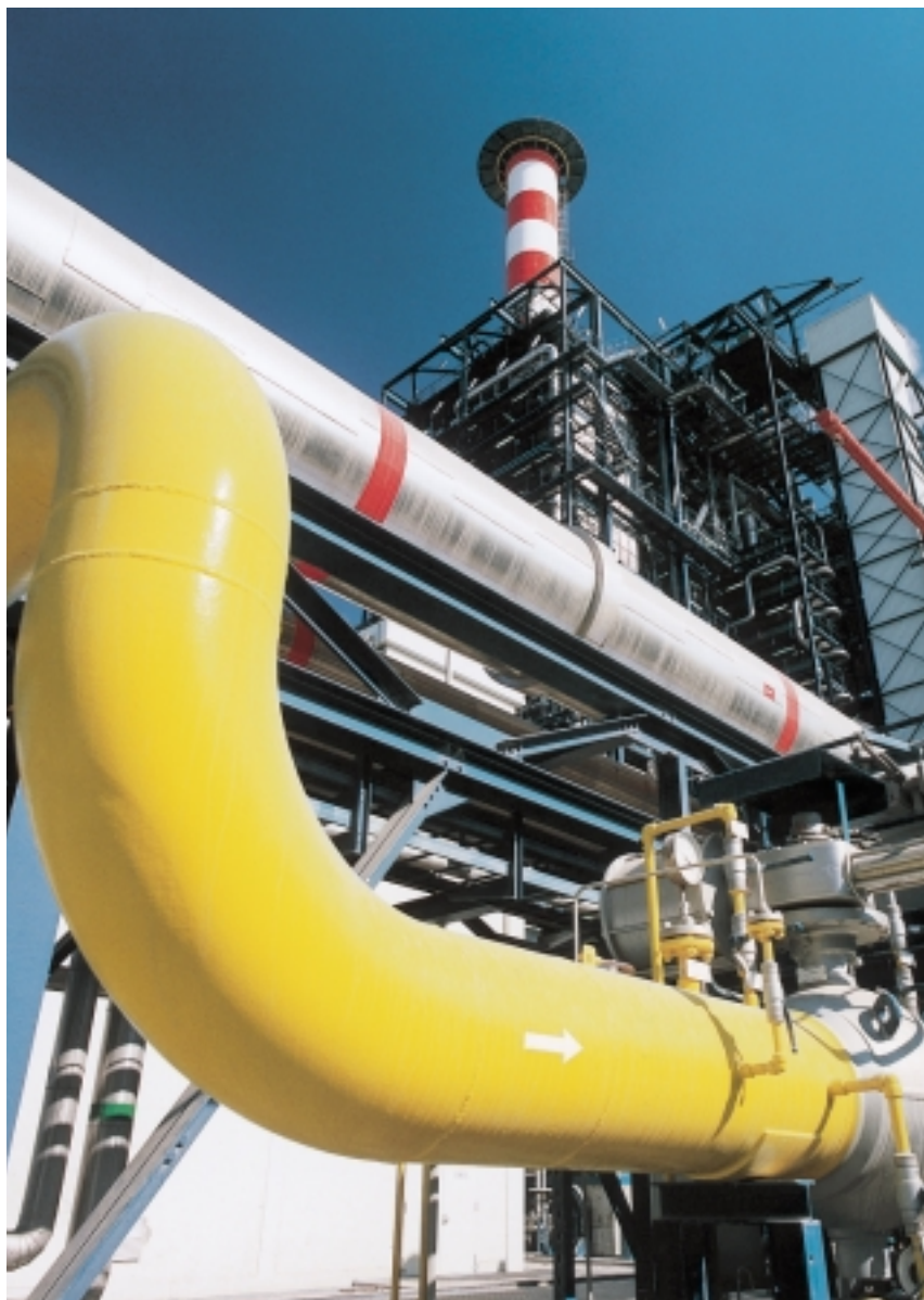
Conduite d'alimentation de gaz vers l'un des 6 générateurs de vapeur de la centrale énergétique Al Taweelah B
