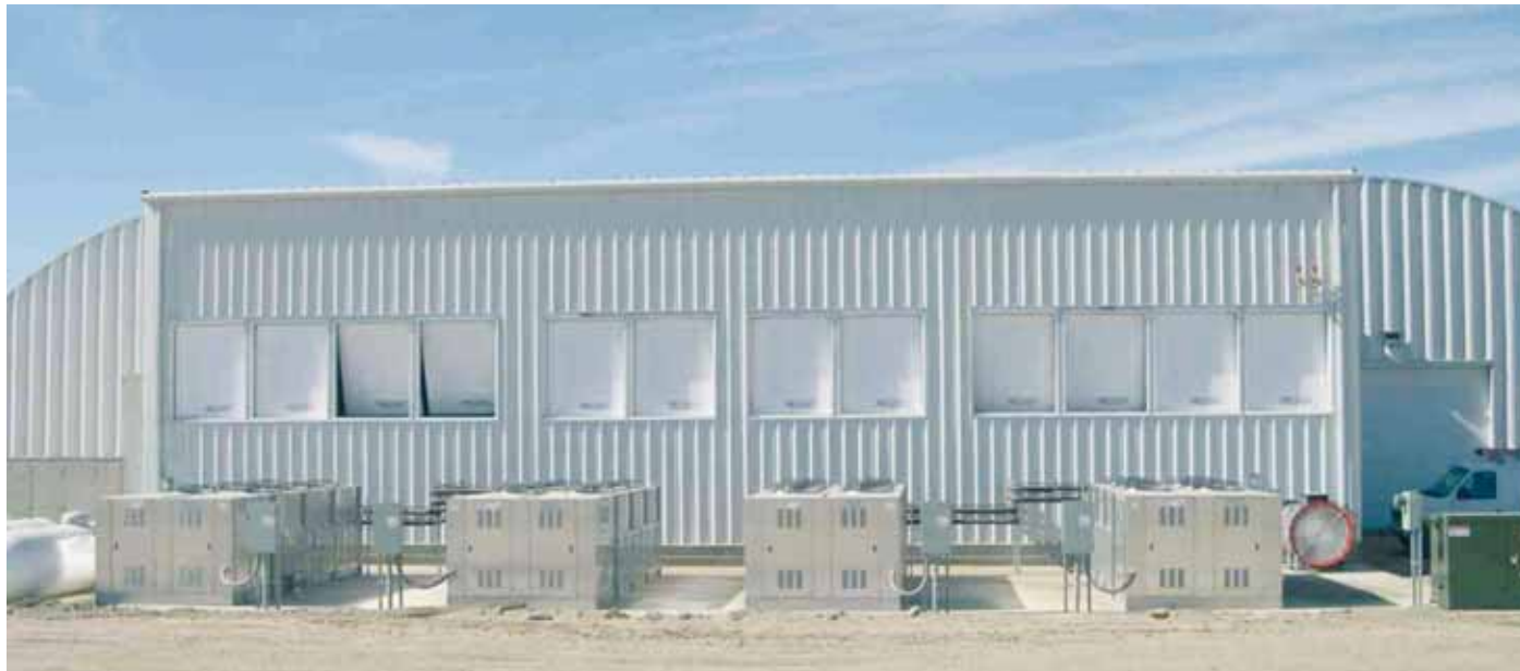
Las modernas instalaciones de almacenamiento de JMC utilizan convertidores de ABB para mantener frescos los productos agrícolas.
