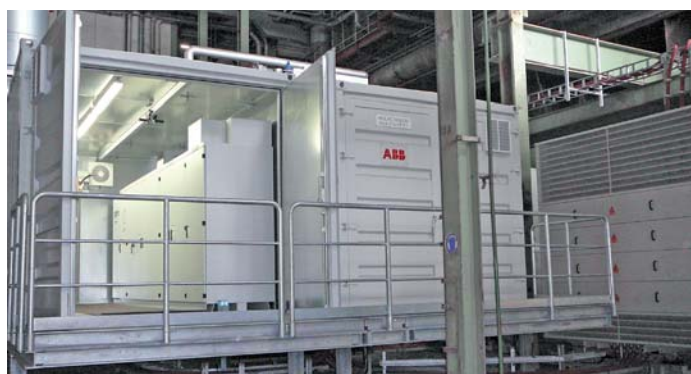
I drive di media tensione ACS 1000 raffreddati ad acqua sono stati installati in appositi container completamente climatizzati.
