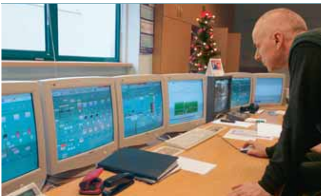
4 Das Leitsystem basiert auf der ABB Advant-Architektur.
