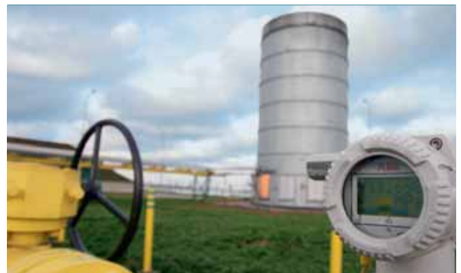
5 Messtechnik von ABB – ein kleiner, aber wichtiger Bestandteil der Anlage
