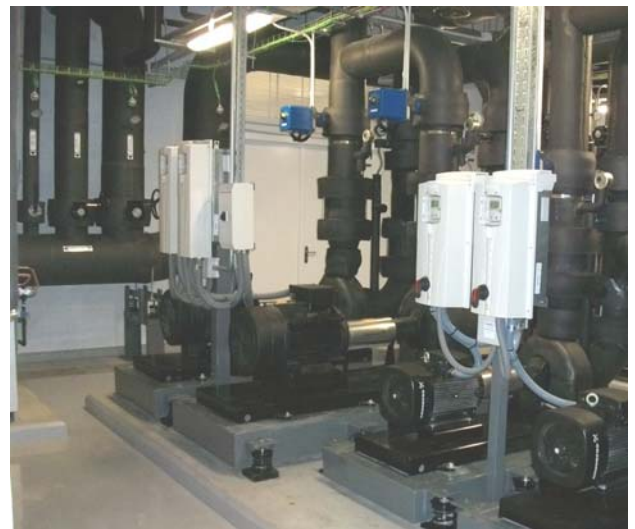
Sistema de bombeo con regulación de velocidad ABB
