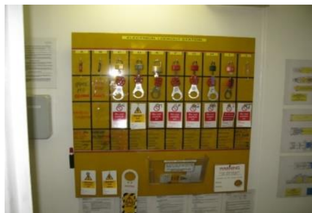
Fig. 2: Control del equipo de bloqueo-etiquetado
