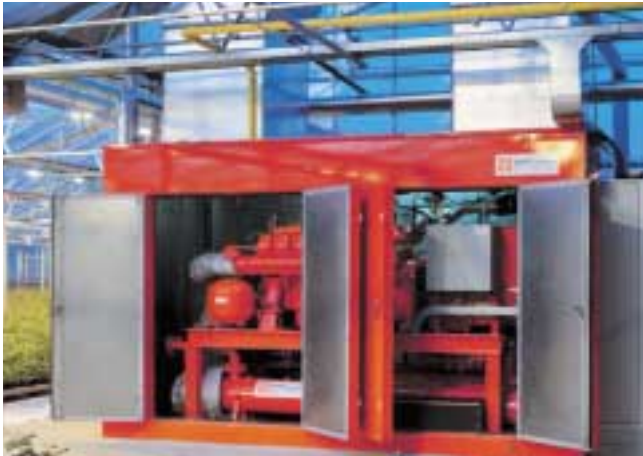
Production combinée d'électricité et de chaleur (cogénération) pour un rendement énergétique maximal.
