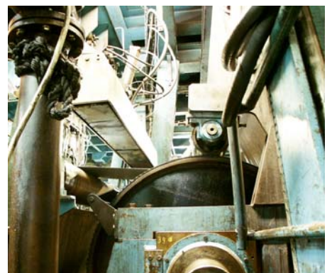
Millmate-Bandscanner in einer Bandbehandlungs-anlage für Edelstahl.
