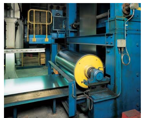
Große PillowBlock-Bandzugmesser in einer Kontigluhanlage.
