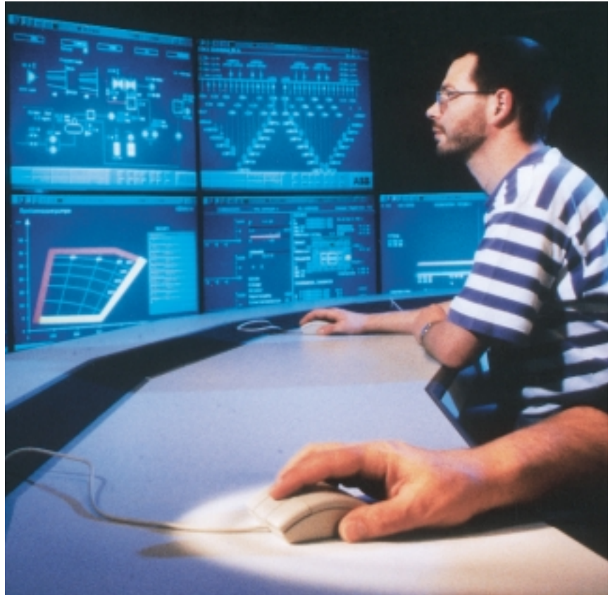
Die Betriebsführung im Kraftwerk Schkopau erfolgt über Großbildschirme und Bedienmaus 2
