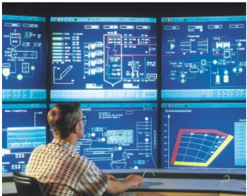
Großbildwand zur Prozeßüberwachung und -bedienung 3
