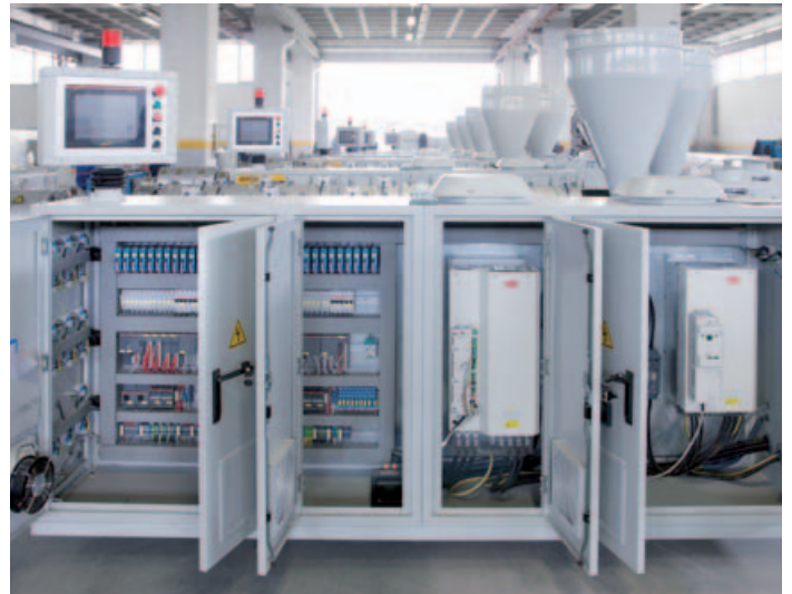
Sarem instala convertidores de frecuencia, motores, paneles de operador, PLC y productos de baja tensión de ABB en sus máquinas.
