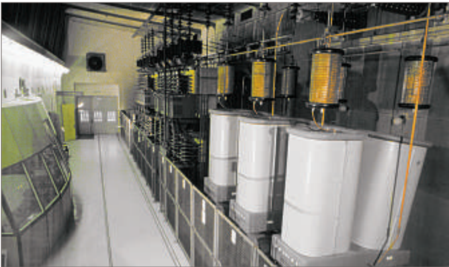
Extension de Gotland 1 avec les premières valves à thyristors CCHT au monde
