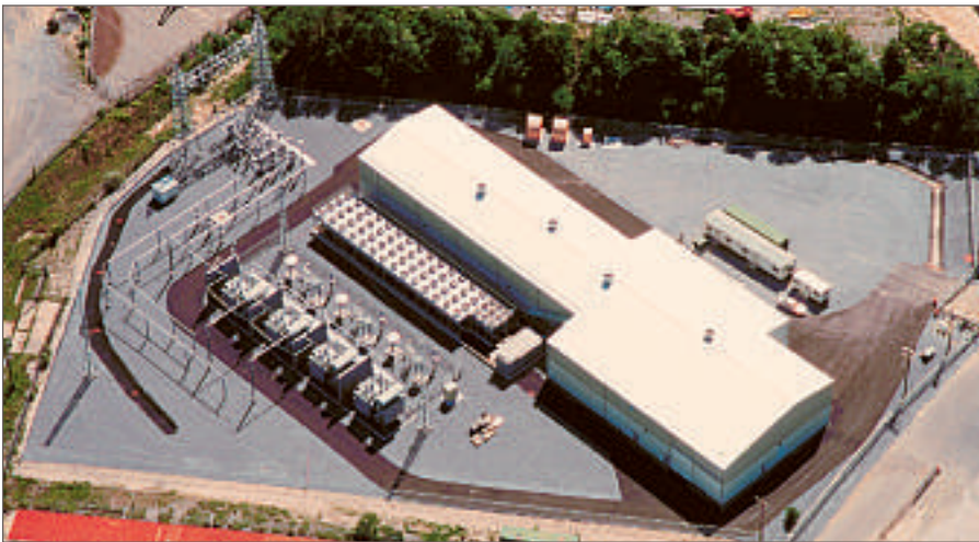
Station de Shoreham de la liaison HVDC Light de 330 MW de Cross Sound Cable aux Etats-Unis
