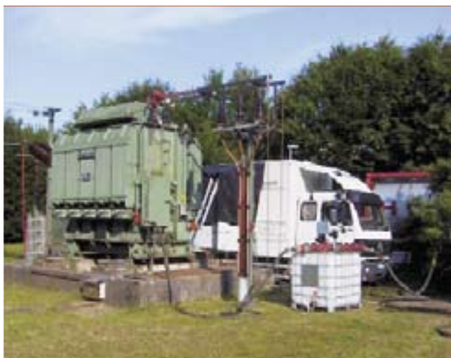
4 Передвижной модуль LFH для сушки трансформаторов на месте установки
